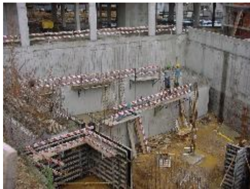
Figura 5.20 – Pormenor construtivo da cisterna de armazenamento de água do empreendimento Ponte da Pedra
