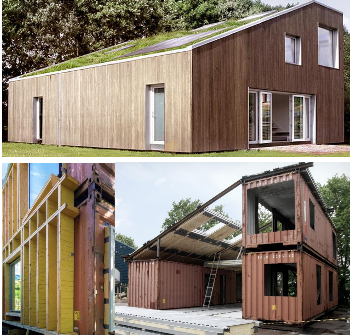
Fig. [33] Imágenes de la cubierta y fachada de la vivienda durante el montaje.
