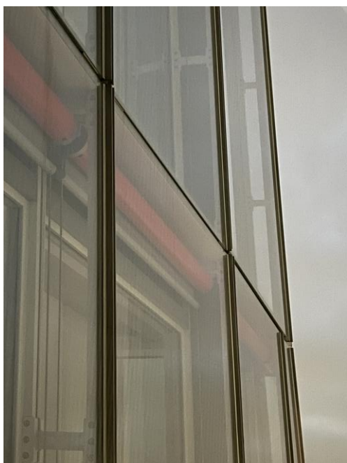
Ilustración 64: Estores motorizados entre ambas peles do The Shard. Autoría propia
