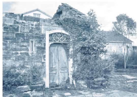
Ilustración 22. Estado en ruina de la capilla. Fuente: Libro Mondariz Balneario. Episodios memorables.
