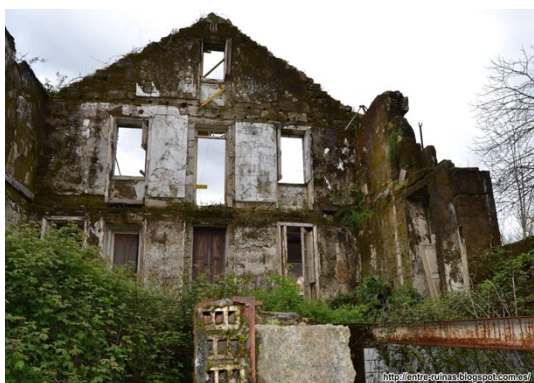
Ilustración 31 Fotografía de la fachada sur por el interior del hotel (2016). Fuente: https://www.facebook.com/urbex.entruinas/posts/1690141211236222/?locale=es_LA
