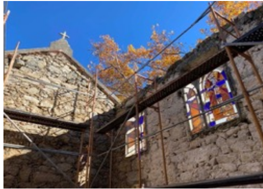
Ilustración 73. Interior de la iglesia, en donde se ven las vidrieras a rehabilitar (2022). Fuente: Radio Val do Minho.
