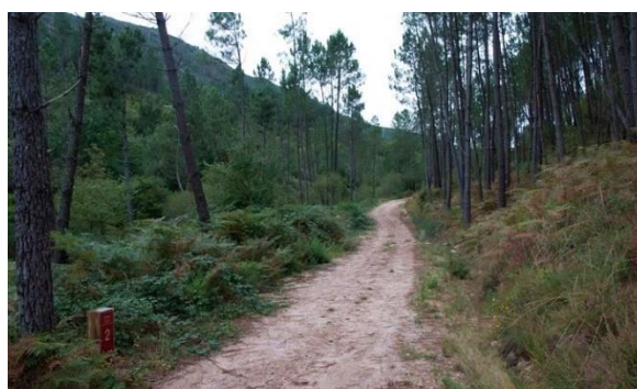
Fig. 196 – Camiño Natural do Interior, actualmente con pavimento degradado e sinalización destruída.
