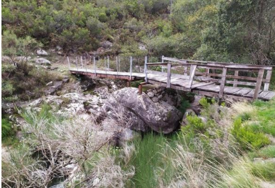
Fig. 213 – Ponte en mal estado na ruta das Minas das Sombras.
