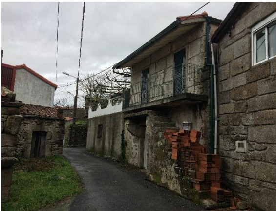
Fig. 217 – Perda das escadas de acceso da tipoloxía tradicional das vivendas.
