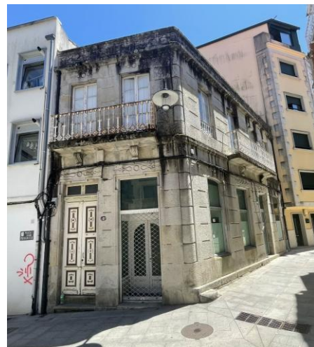
Fig. 82.- Vivienda con protección estructural en estado de abandono, 2025. Fuente: Elaboración propia.
