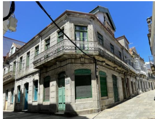
Fig. 100.- Antiguos bajos comerciales y vivienda en desuso, protección integral y estructural, 2025. Fuente: Elaboración propia.
