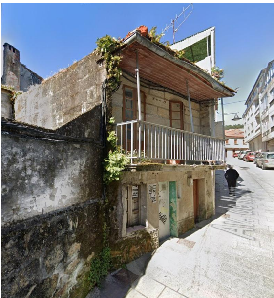
Fig. 59.-Vivienda de solaina con protección ambiental en estado de abandono. Fuente: Google Street View (2023)
