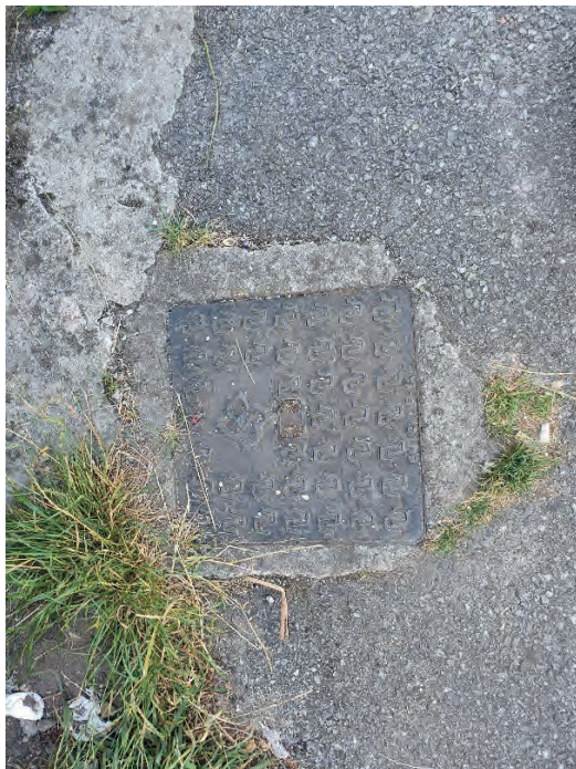
Figura 28: Conexión a la instalación de suministro de agua. Fuente: elaboración propia
