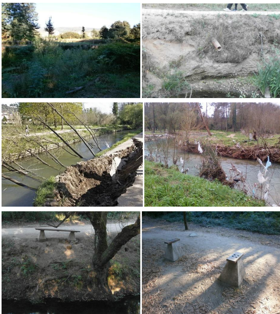
Ilustración 3. Imágenes del estado actual de las márgenes del río Louro a su paso por el centro urbano de Porriño.
