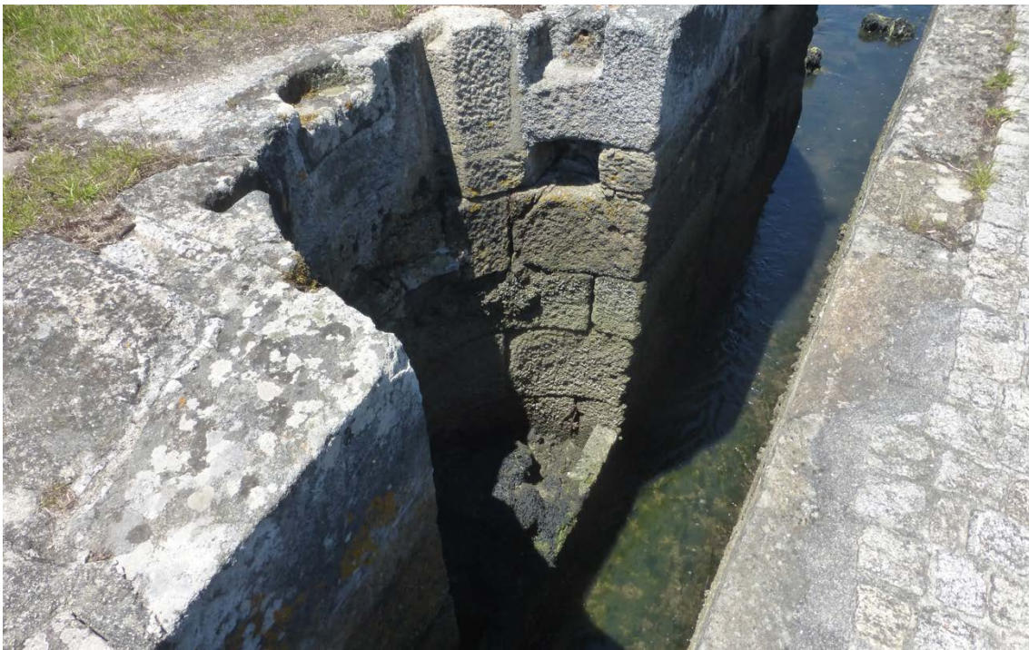
Figura 29 Estado actual del canal para el antiguo molino de mareas de eje vertical.
