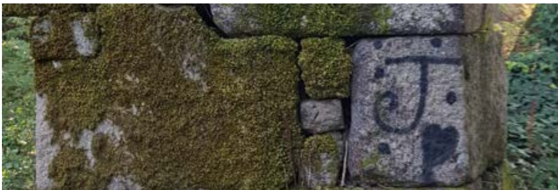
Figura 66 Pintadas en la fachada exterior de la puerta sur.
