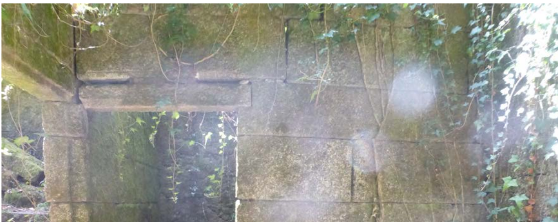
Figura 125 Dintel con elevado riesgo de colapso estructural.
