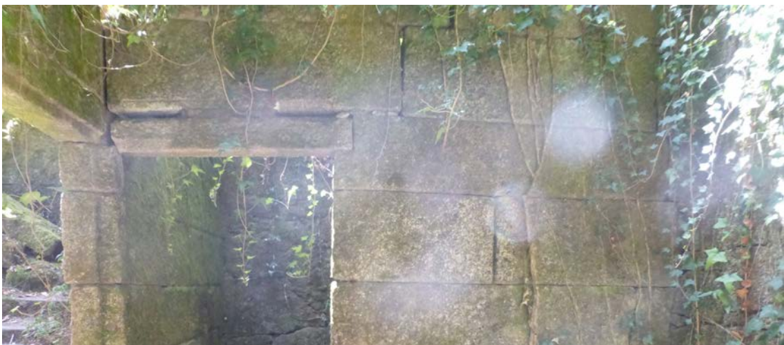
Figura 27 Dintel con elevado riesgo de colapso estructural.
