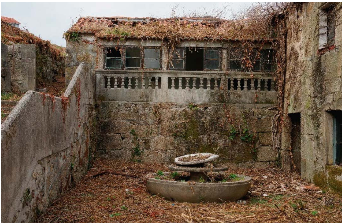
Figura 27 Fachada sur del pazo de O Real, Moaña, Galicia. Un caso de ruina urbanística.
