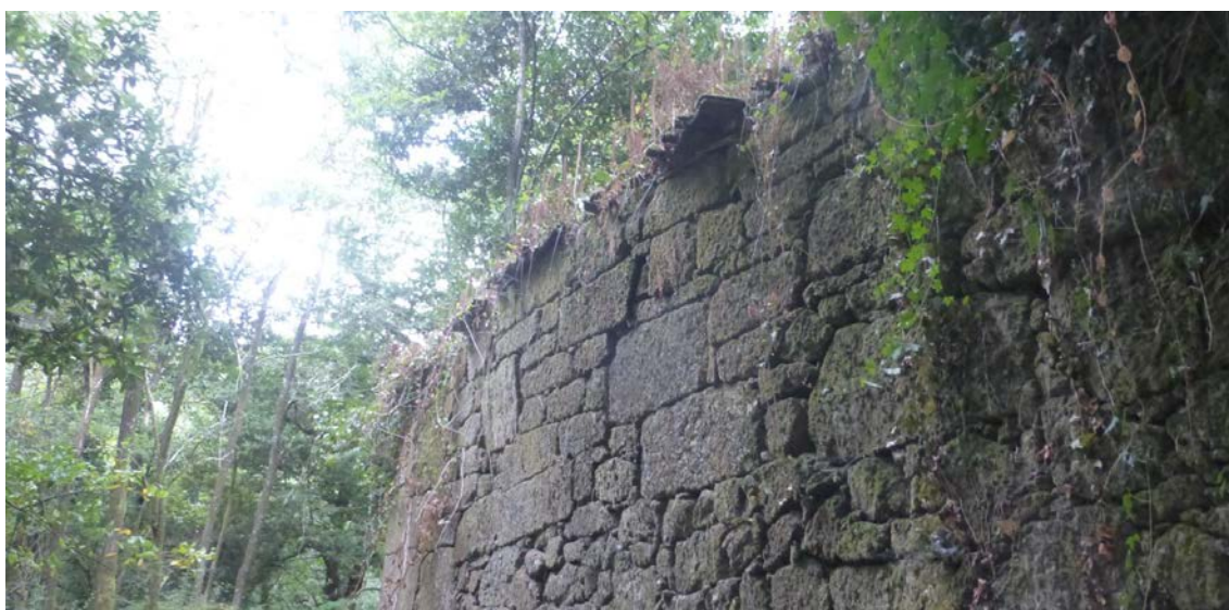
Figura 126 Pequeña deformación en el alzado exterior del muro sur.
