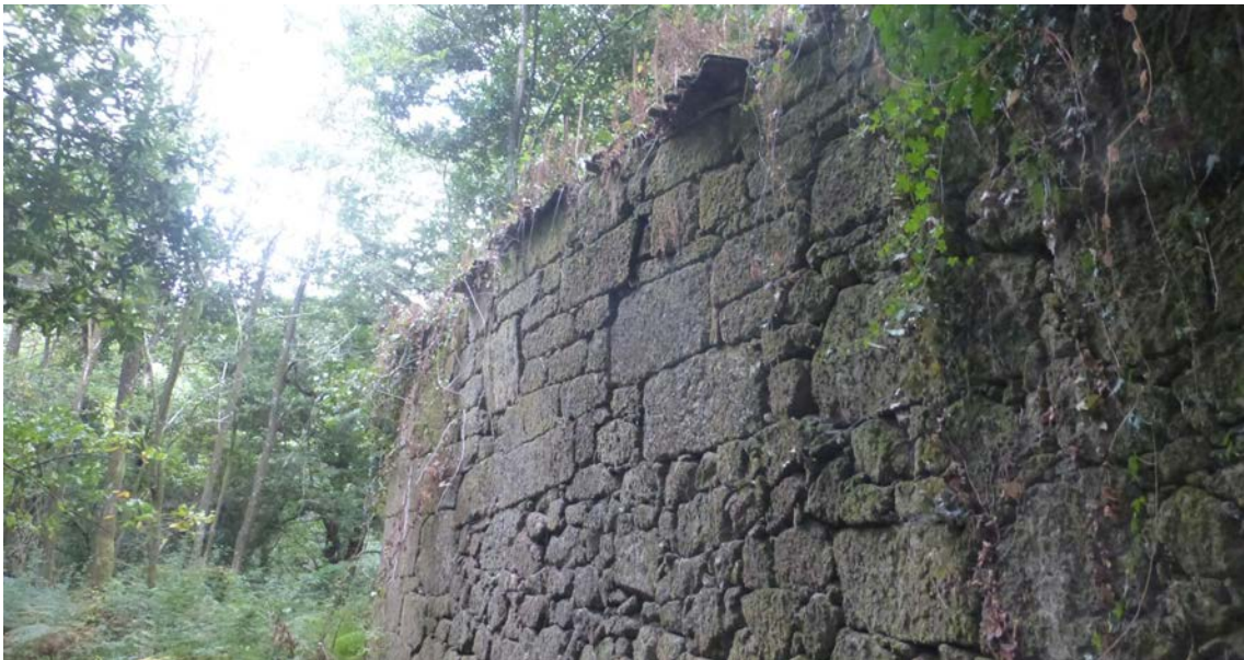
Figura 26 Pequeña deformación en el alzado exterior del muro sur.
