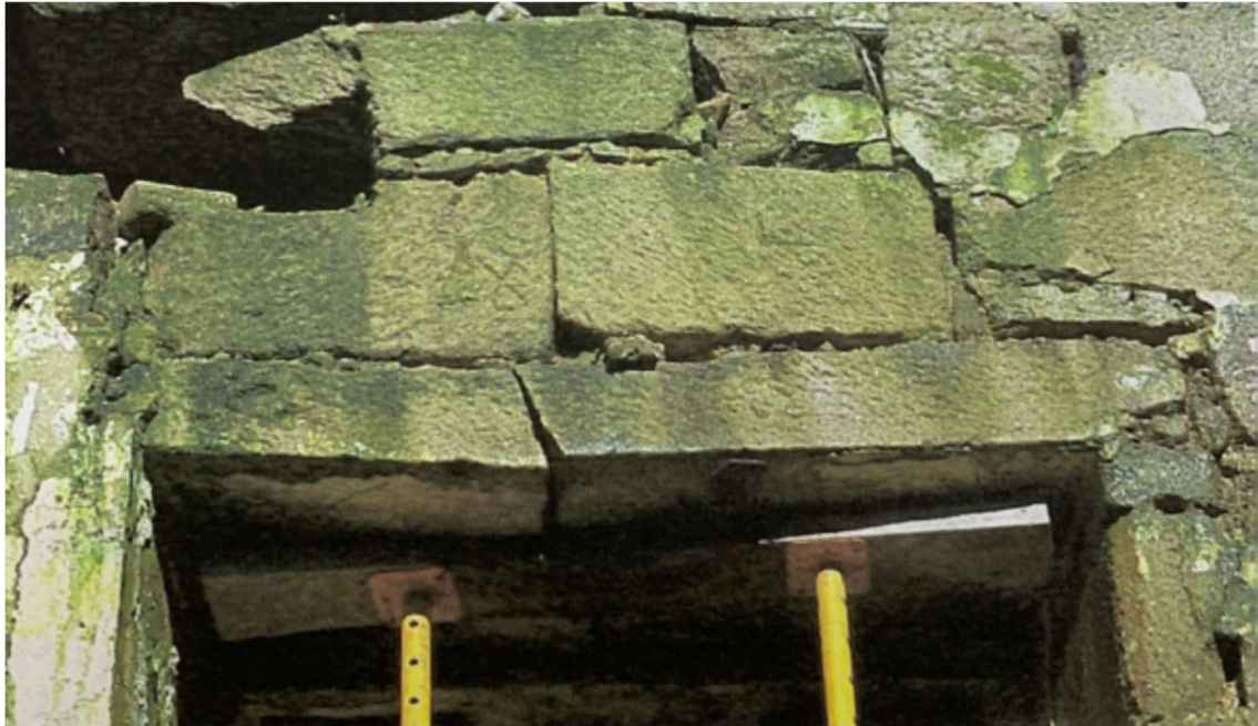
Figura 76. Dintel quebrado de vano de fachada.
