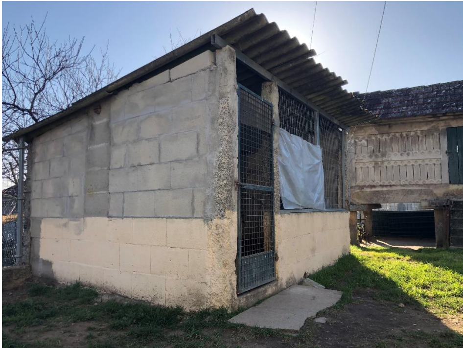
Figura 168. Recinto animal con cambios de material, en cubierta y fachadas. Autoría propia (2023).
